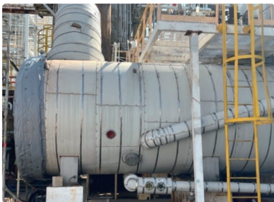
仁武碳纖廠汰舊換新污染防制設備 ( 廢液及廢氣焚化爐 )
