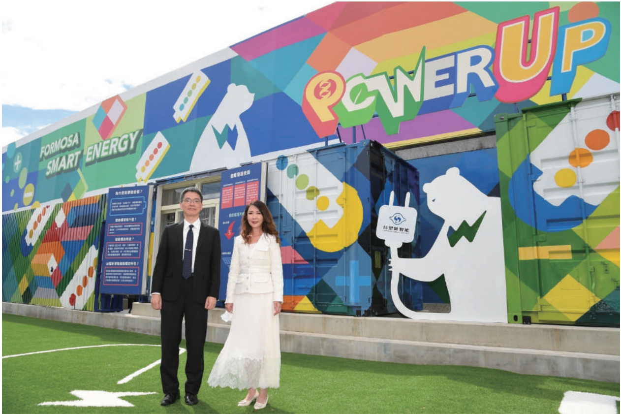
台塑新智能公司彰化廠 1.2MW( 百萬瓦 ) 儲能櫃案場
