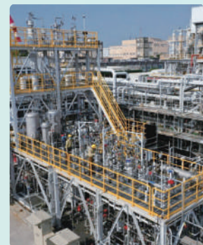
煙道氣化學固碳捕獲再利用試驗工廠實景
