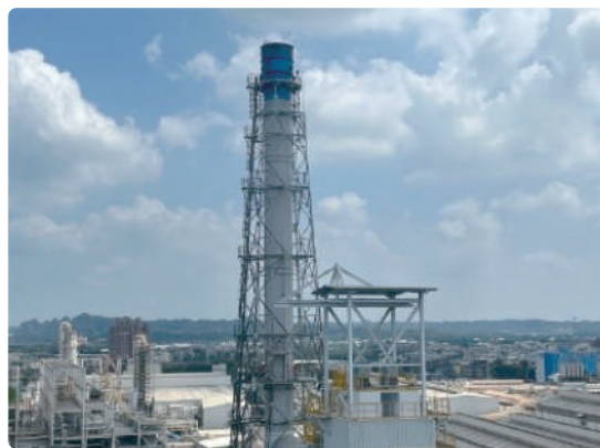
仁武公用廠增設污染防制設備 ( 濕式靜電集塵器 )
