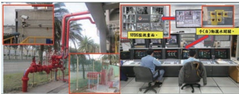
圖 8 智慧型火警影像辨識系統連動消防自動撒水系統
